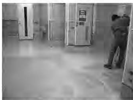
SPコーティング施工の様子。水や油を弾き、日常メンテナンスが容易になる
